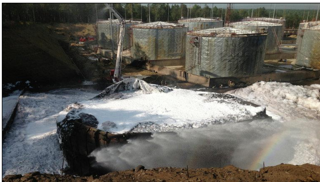
Рисунок 1.18 – Последствия разрушения РВС-5000 м 3 в резервуарном парке ЗАО ПК «Дитэко»
